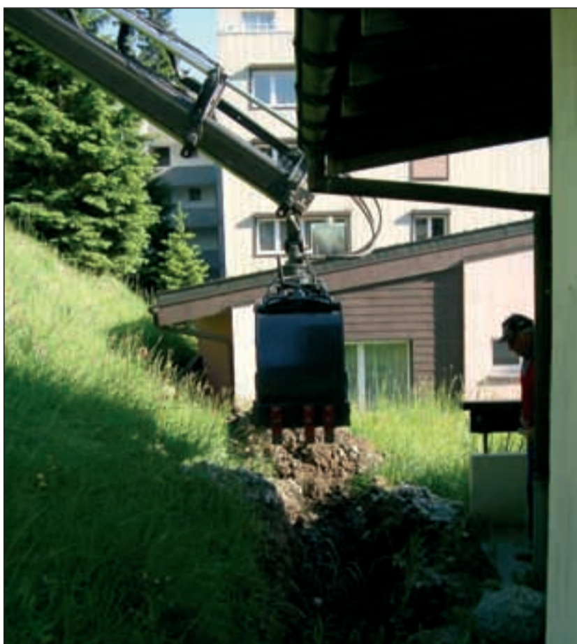
... son grappin Grapner accèdera rapidement et effectuera sans problèmes tous travaux de terrassement.
